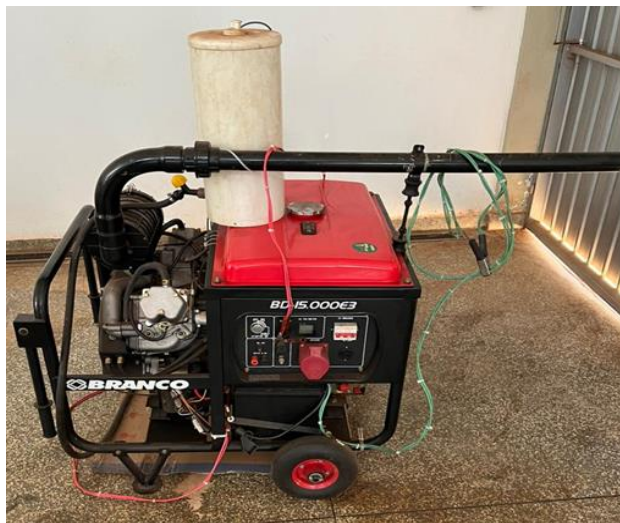
Figura 6 – Motor gerador Branco BD-15.000 E3 (Fonte: Autores).
