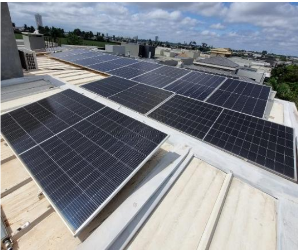
Figura 2 – Sistema fotovoltaico instalado analisado neste estudo.
