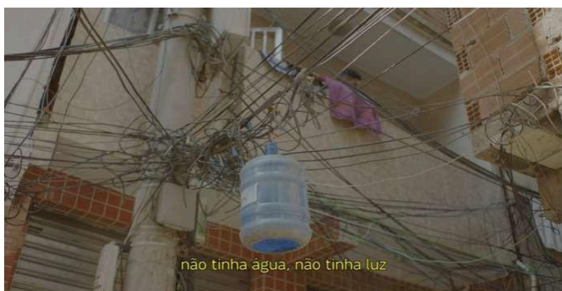
Figura 15 - Galão de água preso em emaranhado de fios de energia.
