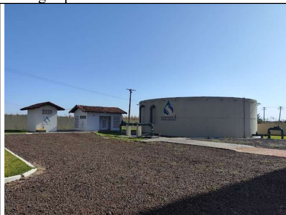
Captação de água super poço - SANESUL Dourados, 2023
